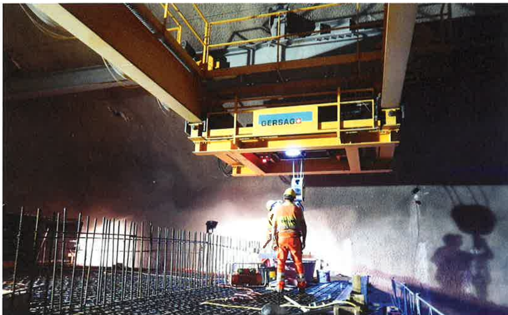
Baulogistik vom Feinsten: Der Deckenkran wird während der Bauphase zum Ausbau der Kaverne eingesetzt.
