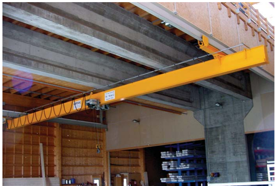
Deckenlaufkran mit Auskargung
