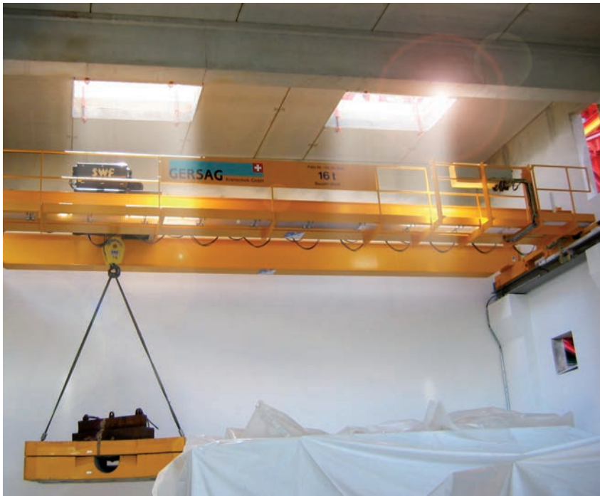
Krananlage 16 t in Leudelange (LUX)
