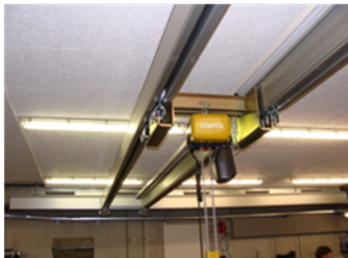
Mechanische Werkstatt: gedrängte Bauart für maximale Hakenhöhe
