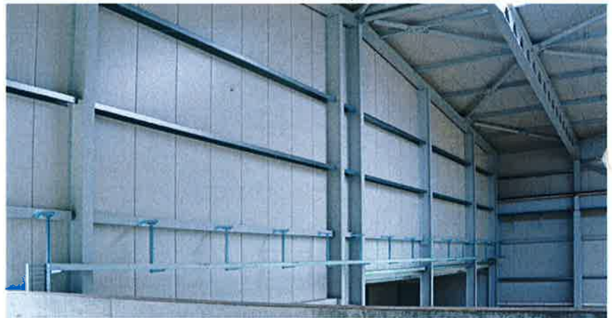
Stirnwand mit Kabeltrasse
